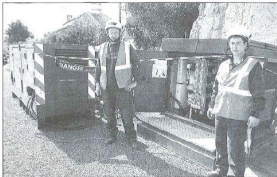
Les électriciens vont débrancher le groupe électrogène. Le nouveau transformateur va entrer en fonction.
